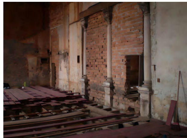
Figura 13: 2º andar afetado pelo incêndio
