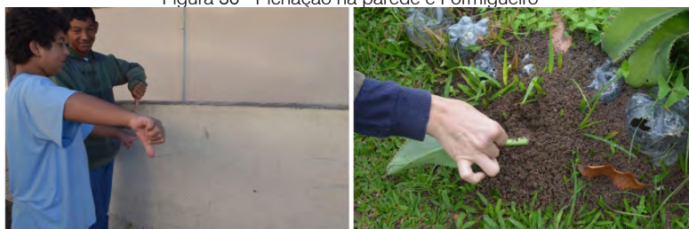
Figura 36 - Pichação na parede e Formigueiro
